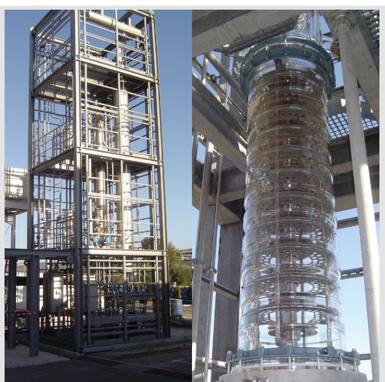
DN400 liquid / liquid extraction column, capacity 800kg/h DN400 flüssig / flüssig Extraktionskolonne, Kapazität 800kg/h
